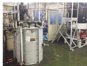
バナジウム回収パイロットプラント
