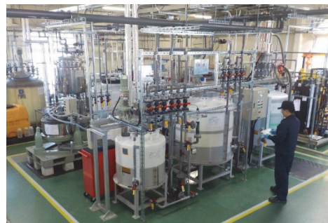
電解液パイロットプラント
