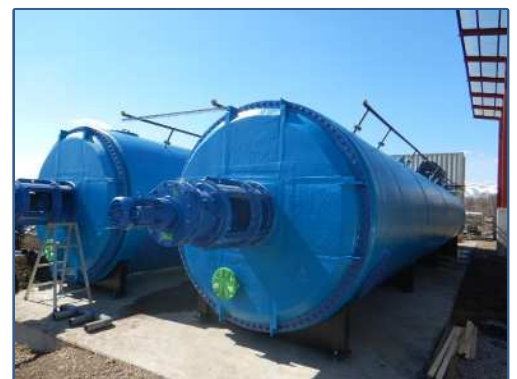
乾式メタン発酵槽
