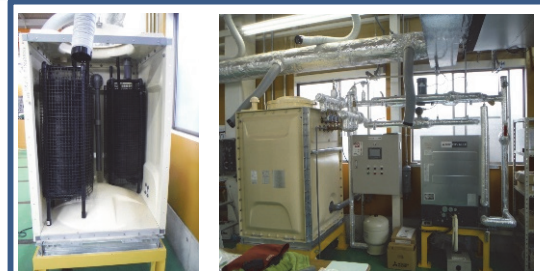
井戸水などの熱利用による空調
